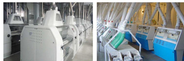
马来西亚400T/D制粉项目 400T/D Flour Mill, Malaysia
